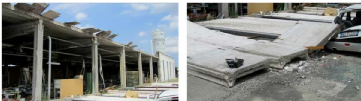
Slika 47: Porušitev stika fasadnega panela in nosilne konstrukcije ( Emilia - Romagna 2012)
