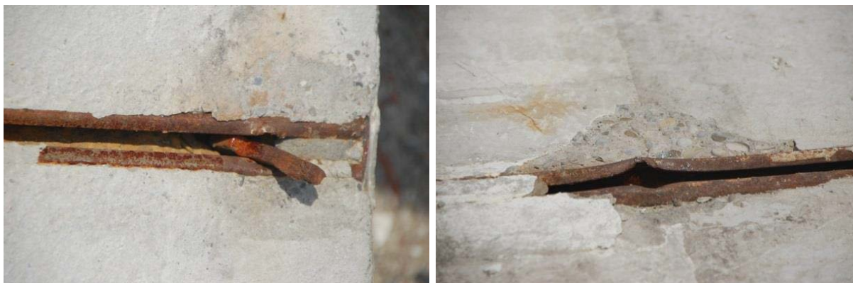
Slika 58: Porušitev stika. Leva slika prikazuje porušitev stika zaradi pretrga ploščice, desna slika prikazuje porušitev stika zaradi porušitve kanala
