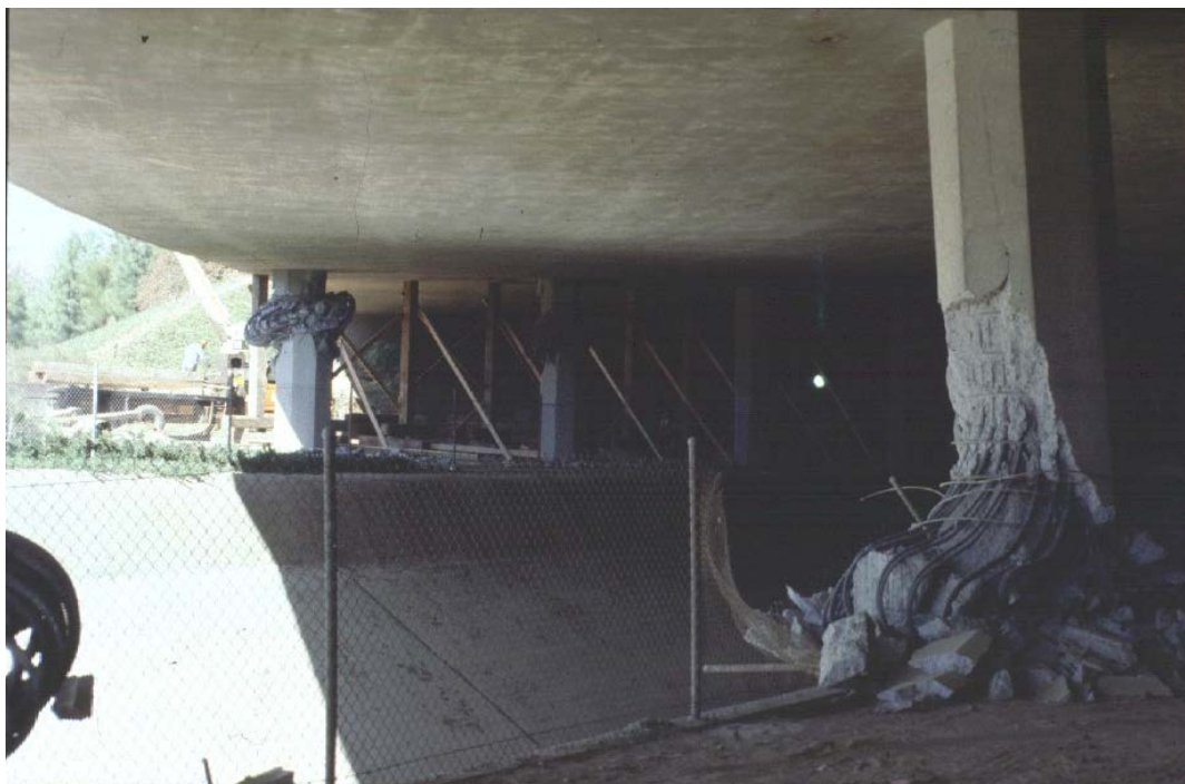
Slika 24: Razpad betonskega jedra zaradi prešibkih stremen
