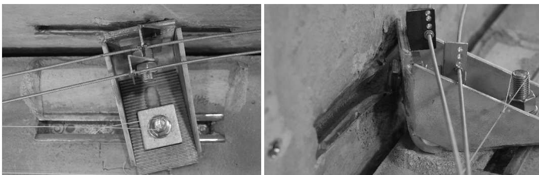
Slika 3.19: Odziv stikov PARD2: kotnik rotira okrog vijaka v nosilcu, pri tem pa se naslanja na panel, kar povzroči natezne sile v vijaku v panelu (levo); končno se stik poruši zaradi izpuljenja vijaka iz kanala (desno).
