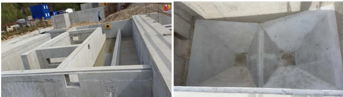
Slika 49: Komore za globinsko filtracijo s tkanino na CČN Kranj Figure 49: Chamber for cloth filtration on WWTP Kranj (95.000 PE)
