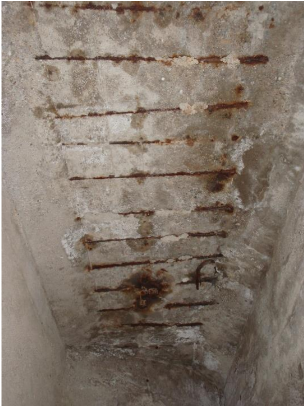
Slika 11: Vidna korodirana armatura na plošči (vir: lasten)
