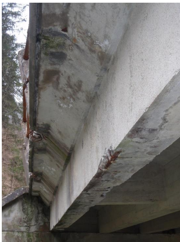
Slika 10: Odkrušen beton na gredi, vidna vzdolžna armatura (vir: lasten)
