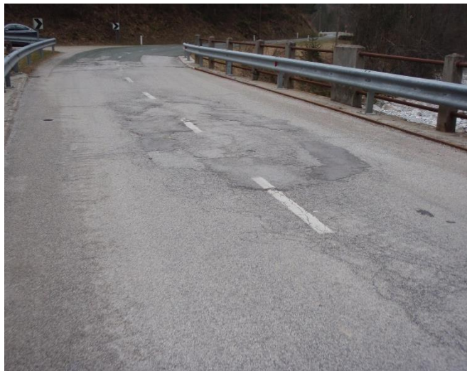
Slika 14: Poškodovanost asfalta (vir: lasten)
