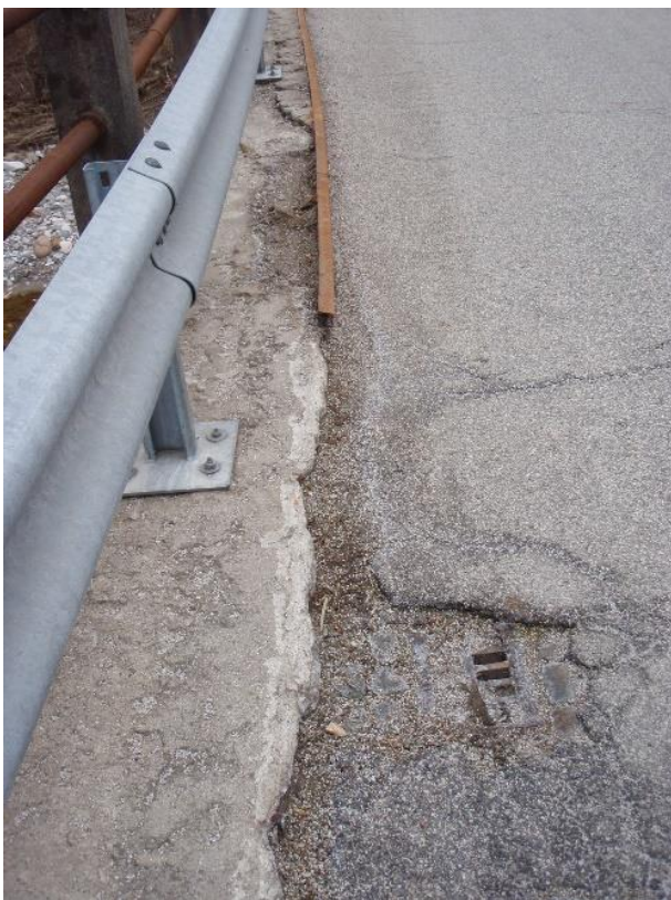
Slika 15: Poškodba robu ceste ter zamašen odtok (vir: lasten)
