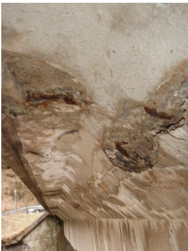
Slika 9: Odkrušen beton na vencu, vpliv soljenja in vremenskih vplivov (vir: lasten)
