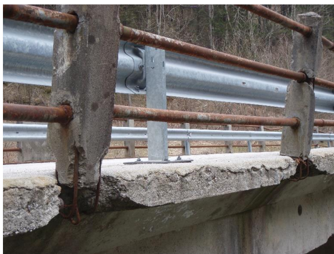
Slika 8: Odkrušen beton s stebra ograje (vir: lasten)
