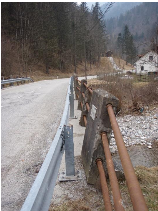
Slika 7: Poškodba ograje (vir: lasten)
