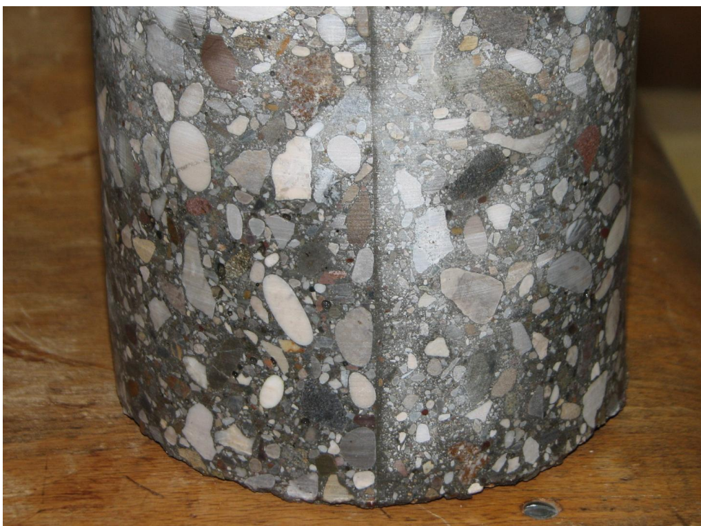
Slika 34: Hladni stik dveh plasti betona
