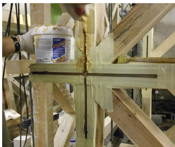
Slika 3.7: Ojačevanje gaiole , tradicionalnega lesenega okvirja v historičnem objektu na Portugalskem (Poletti et al., 2014)
