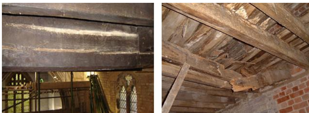
Slika 1.1: Vzdolžna razpoka v nosilcu kot posledica sušenja (levo) in porušitev nosilca zaradi dolgotrajne izpostavljenosti vlagi (desno) (Hoath, 2006)
