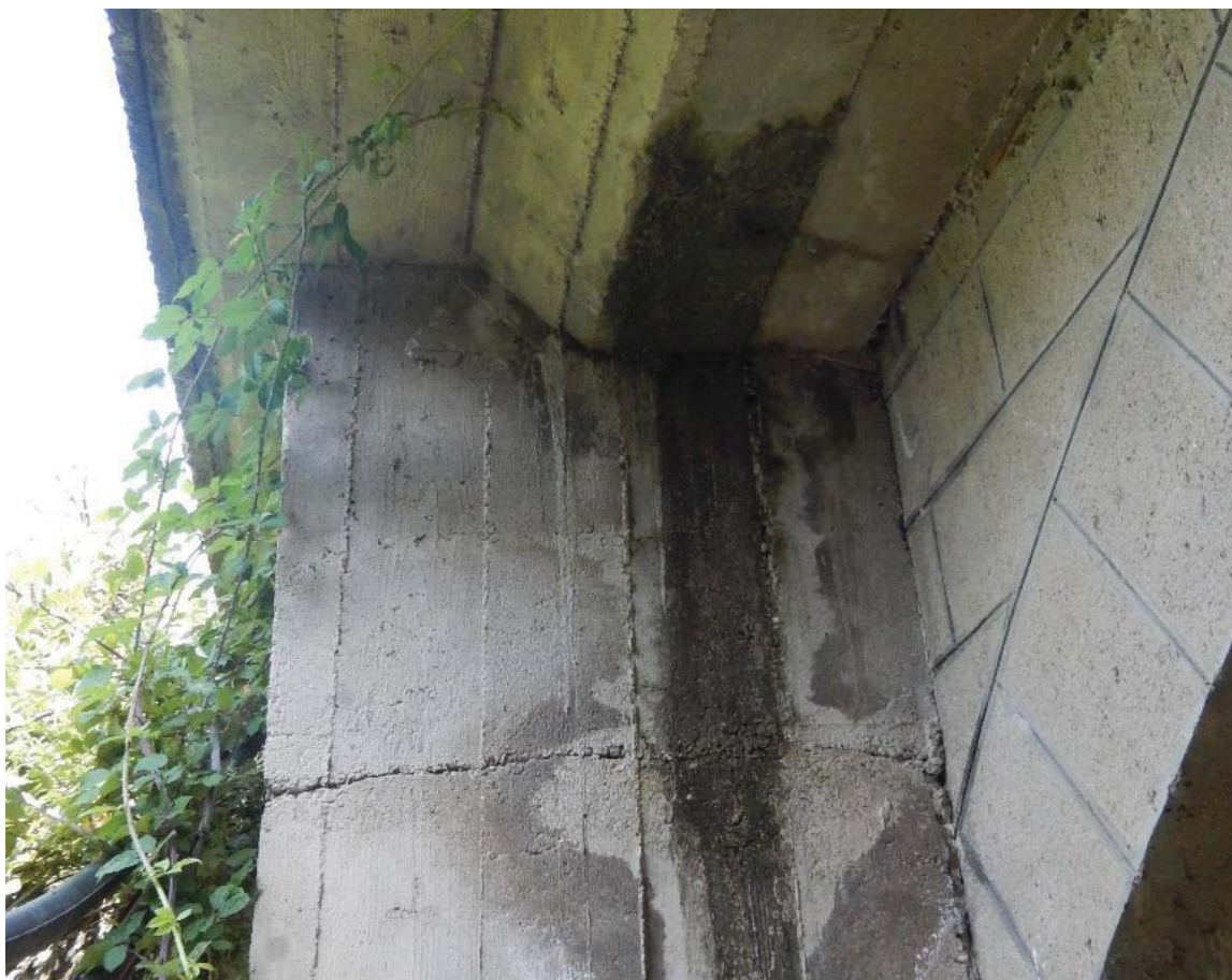
Slika 3 Sledovi zamakanja med dobetoniranim robnim pasom in opornikom
