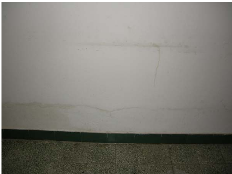
Slika 10: Vlaga v zidovih (ZRMK, 2010)
