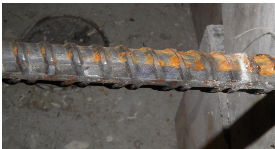
Slika 13: Primer rebrastega armaturnega jekla.
