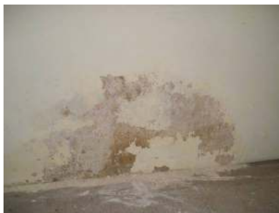
Slika 10: Vlaga zaradi kapilarne vlage (Bartol-Pohl in sod., 2006)
