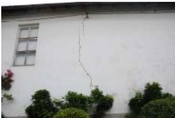
Slika 4: Razpoka na nosilnem zidu (lasten vir)
