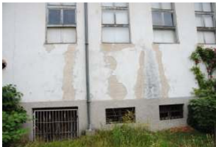
Slika 3: Primer poškodbe na fasadni oblogi (lasten vir)
