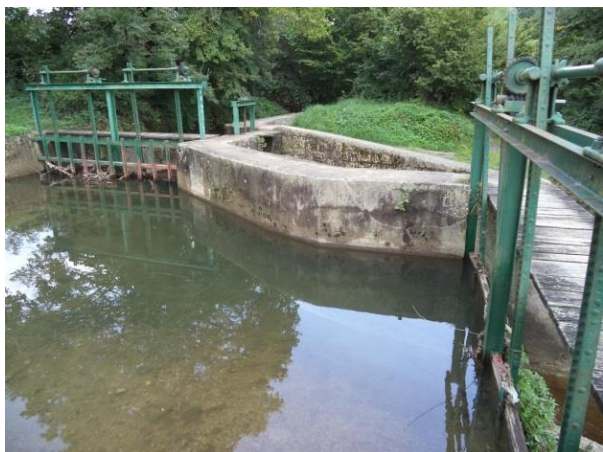
Slika 30: Zapornica za Mestno Gradaščico (levo) in Mali Graben (desno) (Foto: Simon Lesjak)
