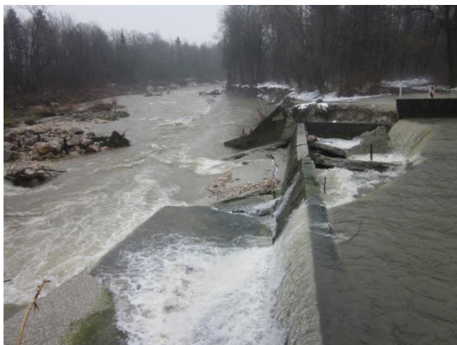
Slika 20: Poškodbe na bočnem prelivu, podslapju bočnega preлива in kar je ostalo od talnega praga (Vir: Hidrotehnik d.d.)
