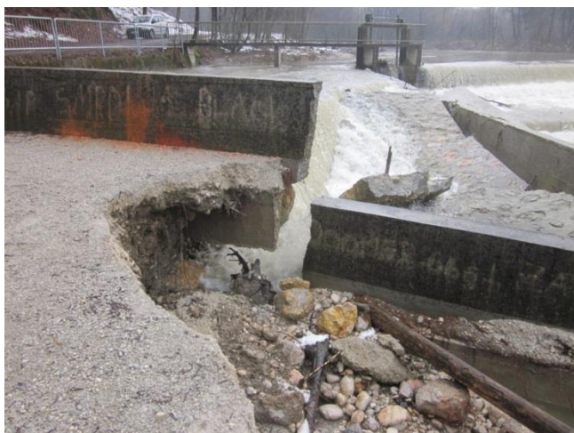
Slika 21: Poškodbe krilnega zidu in desne brežine (Vir: Hidrotehnik d.d.)
