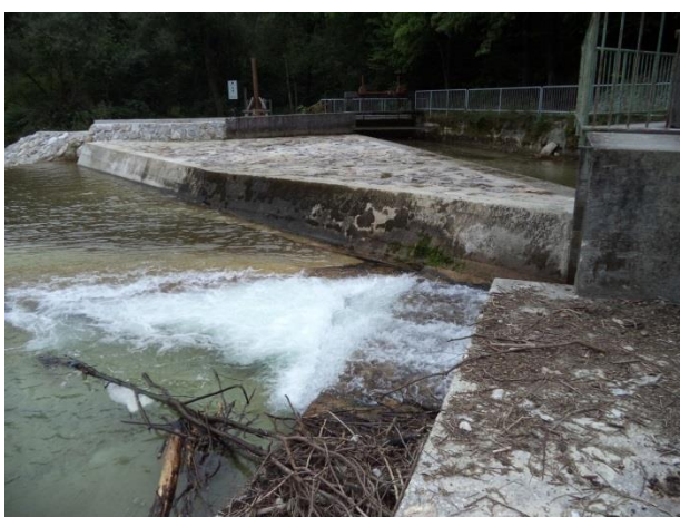
Slika 36: Odlaganje plavin tik ob zapornici pod glavnim jezom (Foto: Simon Lesjak)
