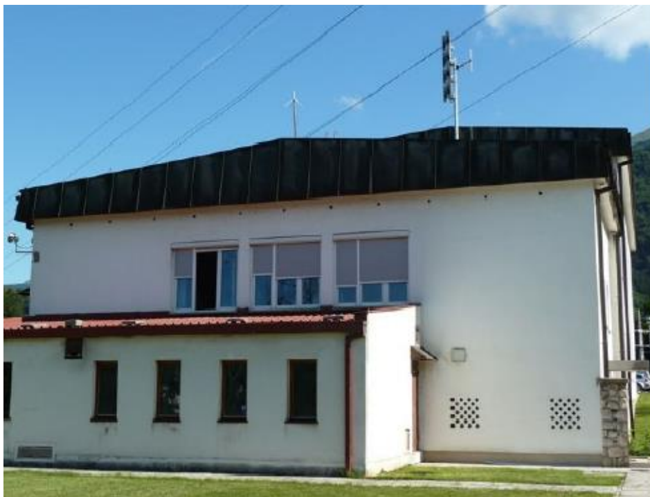
Slika 11: Sirena na strehi komandne stavbe (Alarmiranje SEL, 2011)
