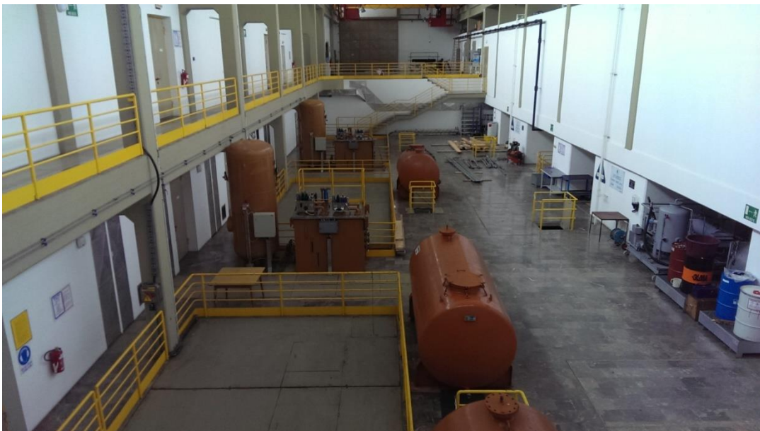
Slika 4: Strojnica hidroelektrarne Vrhovo.
