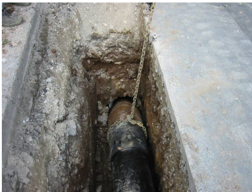
Slika 55: Prikaz vstopne gradbene jame in vstavljanje razbijačne glave v porušeno kanalizacijsko cev ( http://www.vilkograd.com ; 9.1.2007)
