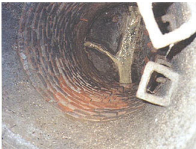
Slika 59: Stanje notranjosti kanalizacijska jaška pred sanacijo ( http://www.trolining.de ; 24.1.2007)
