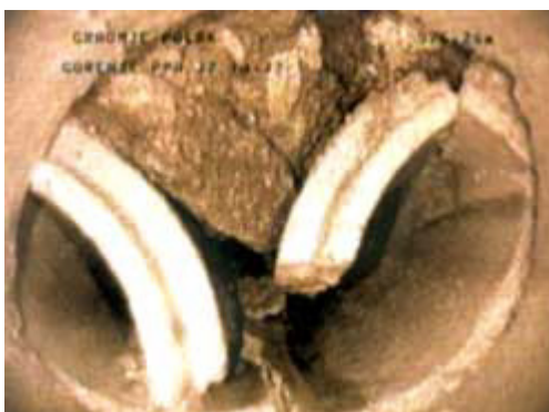
Slika 53: Popolnoma porušena kanalizacijska cev ( http://www.gradnje-polak.com/kanalizacija/uvlacenje.htm ; 9.1.2007)
