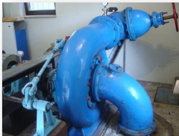
Slika 12: Spiralni okrov Francisove turbine in kolenasti iztok v strojnici mHE Volaka
