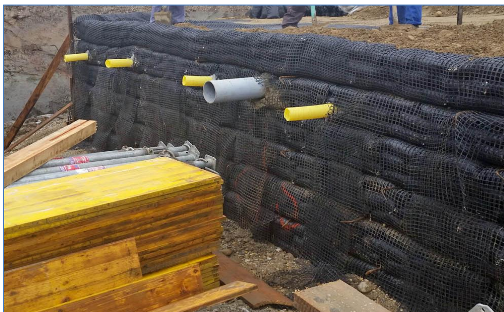
Slika 49: Cev za izvajanje meritev s horizontalnim inklinometrom Figure 49: Pipe for horizontal inclinometer measurements
