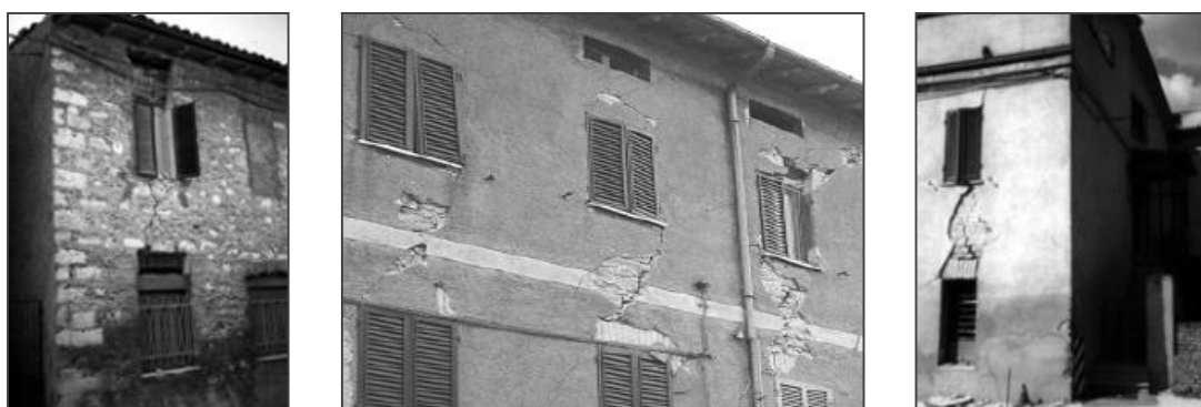
Slika 13: Primeri porušitev prekladnih delov zidu v obstoječih nearmiranih zidanih konstrukcijah (Cattari, 2008).
