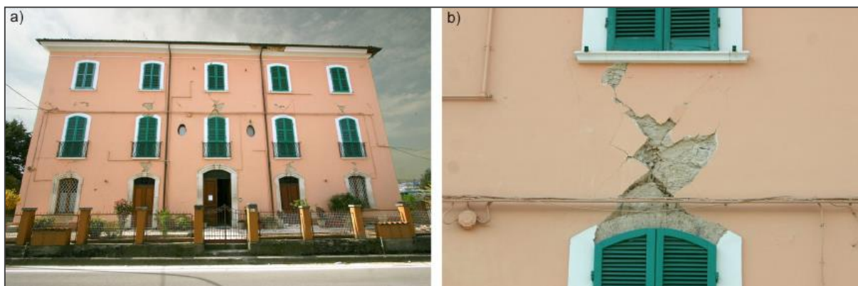
Slika 15: Strižna porušitev prekladnih elementov zidane stavbe v potresu 6. aprila 2009 v L`Aqui (Dazio, Beyer, 2010).
