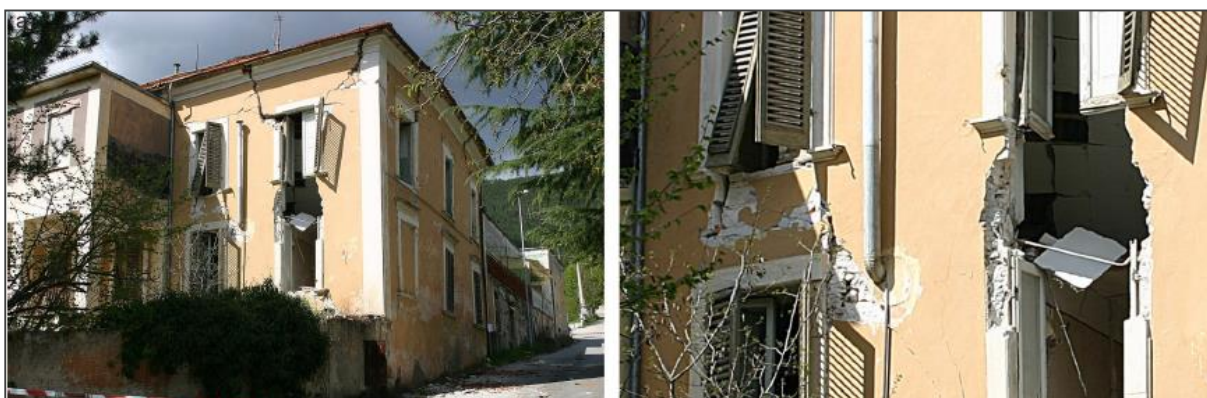
Slika 14: Upogibna porušitev prekladnih elementov zidane stavbe v potresu 6. aprila 2009 v L'Aquila (Dazio, Beyer, 2010).
