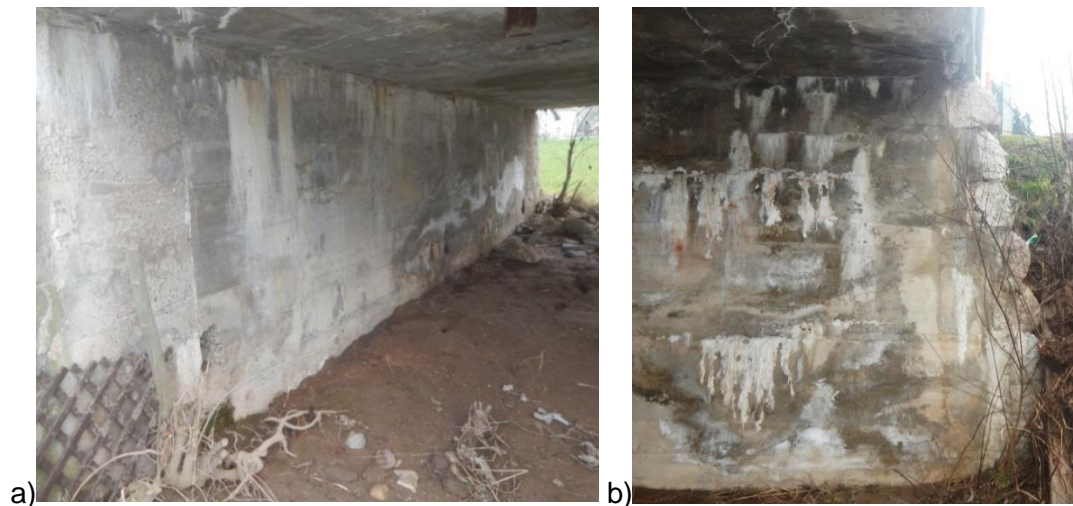
Slika 2: a) Poškodbe desnega krajnega opornika [IRMA, 2014]; b) Poškodbe levega krajnega opornika [IRMA, 2014]
