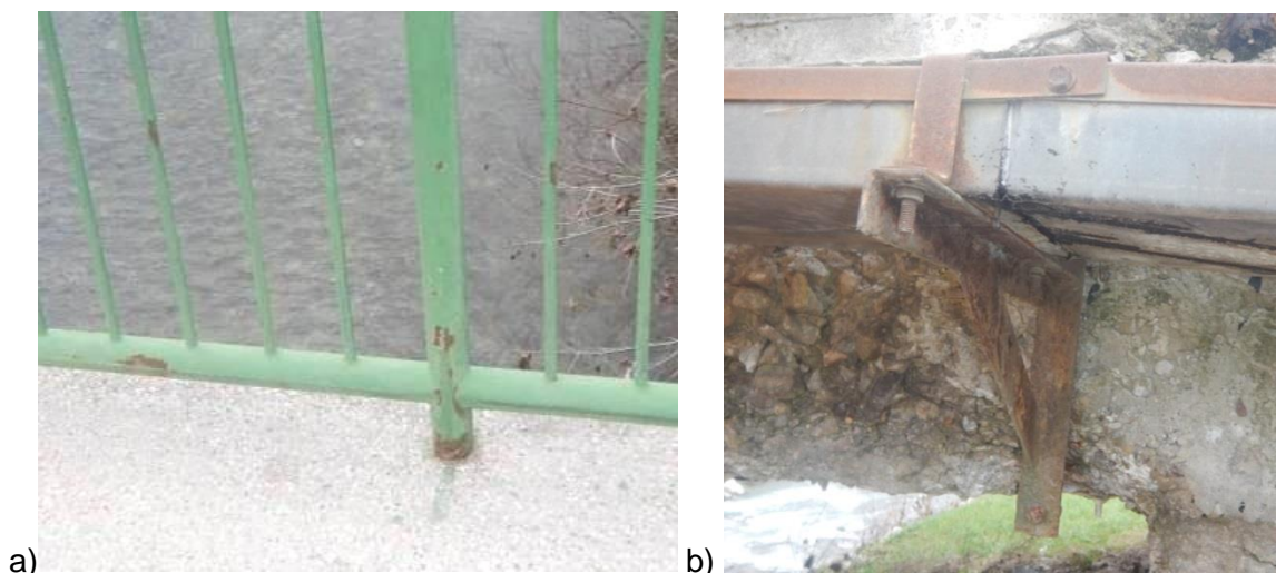
Slika 9: a) Lokalno korodirana ograja hodnikov [IRMA, 2014], b) Korodirana nosilna konstrukcija komunalnih vodov [IRMA, 2014]
