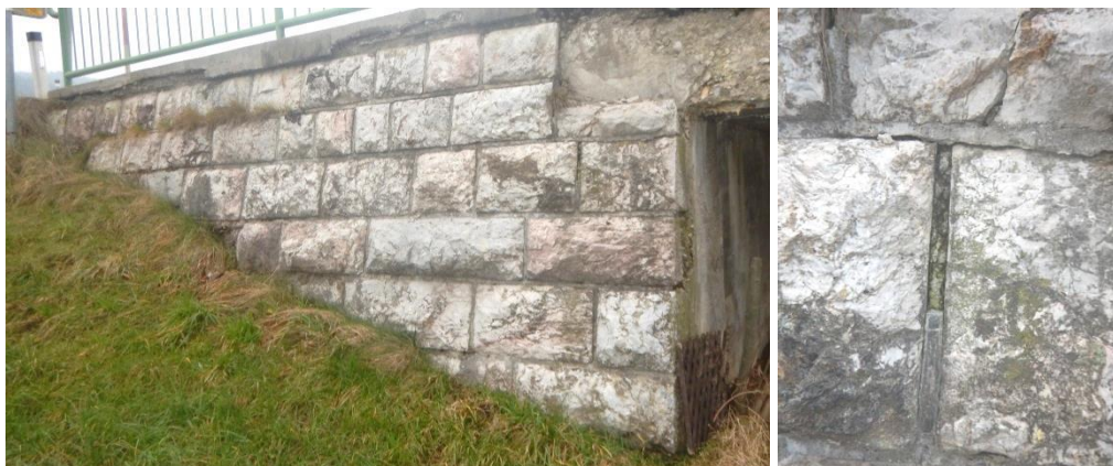
Slika 3: Poškodbe krilnih zidov a) Rast vegetacije, odstopanj in odpadanje betona [IRMA, 2014]; b) Poškodbe krilnih zidov - odpadanje cementne mase iz fug [IRMA 2014]
