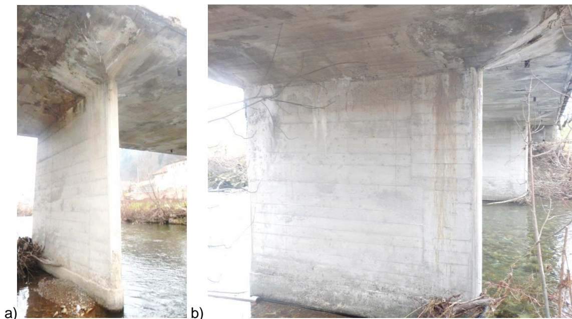
Slika 4: a) Poškodbe desne stenaste podpore (gledano dolvodno) – sledi zamakanja in izločanje korozijskih produktov ter sige v območju vute [IRMA, 2014]; b) Poškodbe leve stenaste podpore (gledano dolvodno) – sledi zamakanja in izločanje korozijskih produktov ter sige [IRMA, 2014]
