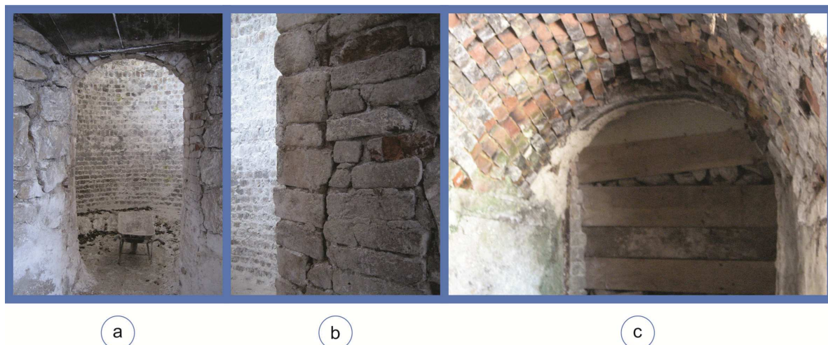
Slika 19: Notranjost zidane peči
