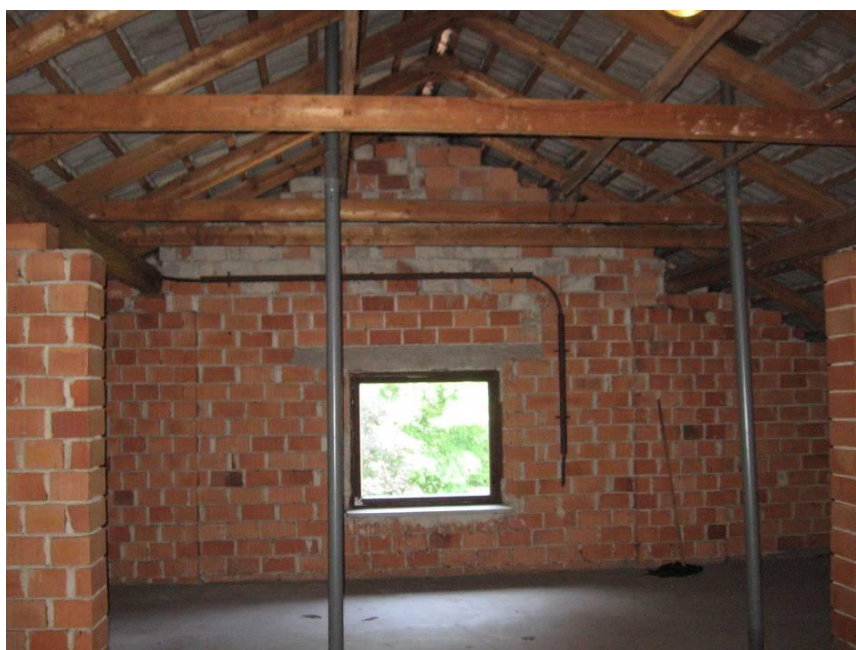
Slika 2: Neizkoriščeno podstrešje in ostrešje strehe (Štampfl, 2012)
