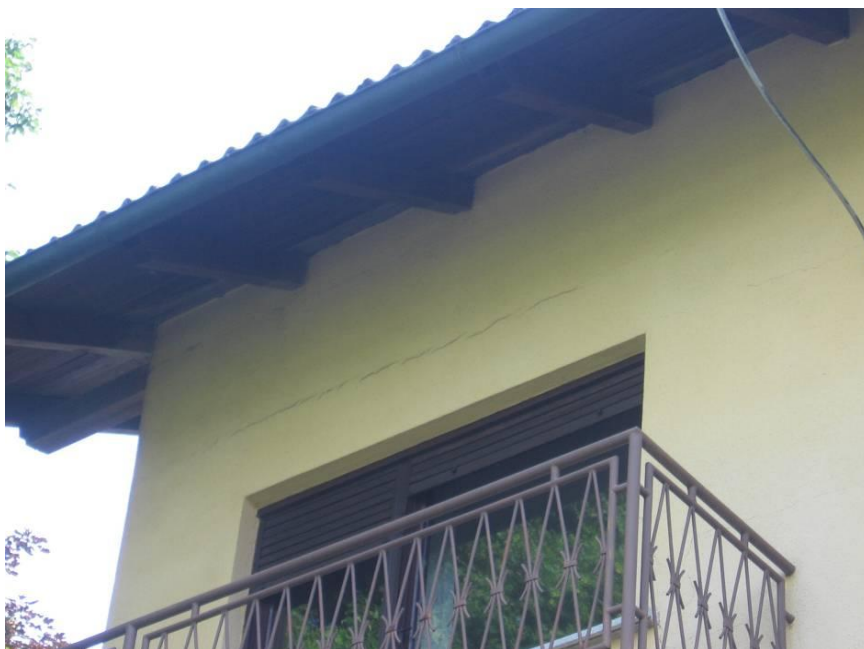
Slika 3: Vodoravna razpoka nad okensko odprtino (Štampfl, 2012)
