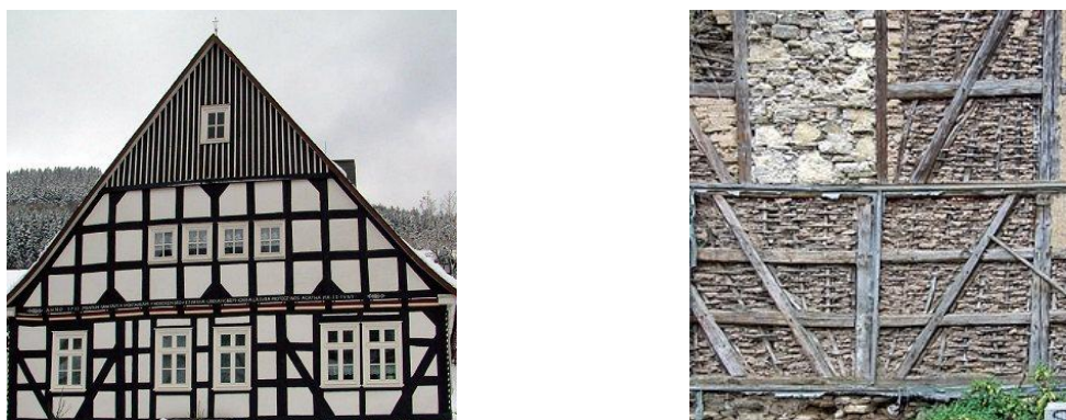
Slika 8: Stavba s predalčno nosilno konstrukcijo – levo; polnilo iz lesa in kamnov - desno (Fachwerk 2, 2015)
