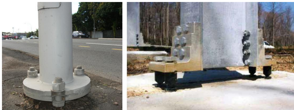
Slika 44: Zdrsnjen spoj (levo) in oslabiljen vijachen spoj (desno) na nogi podpore [108] [49]
