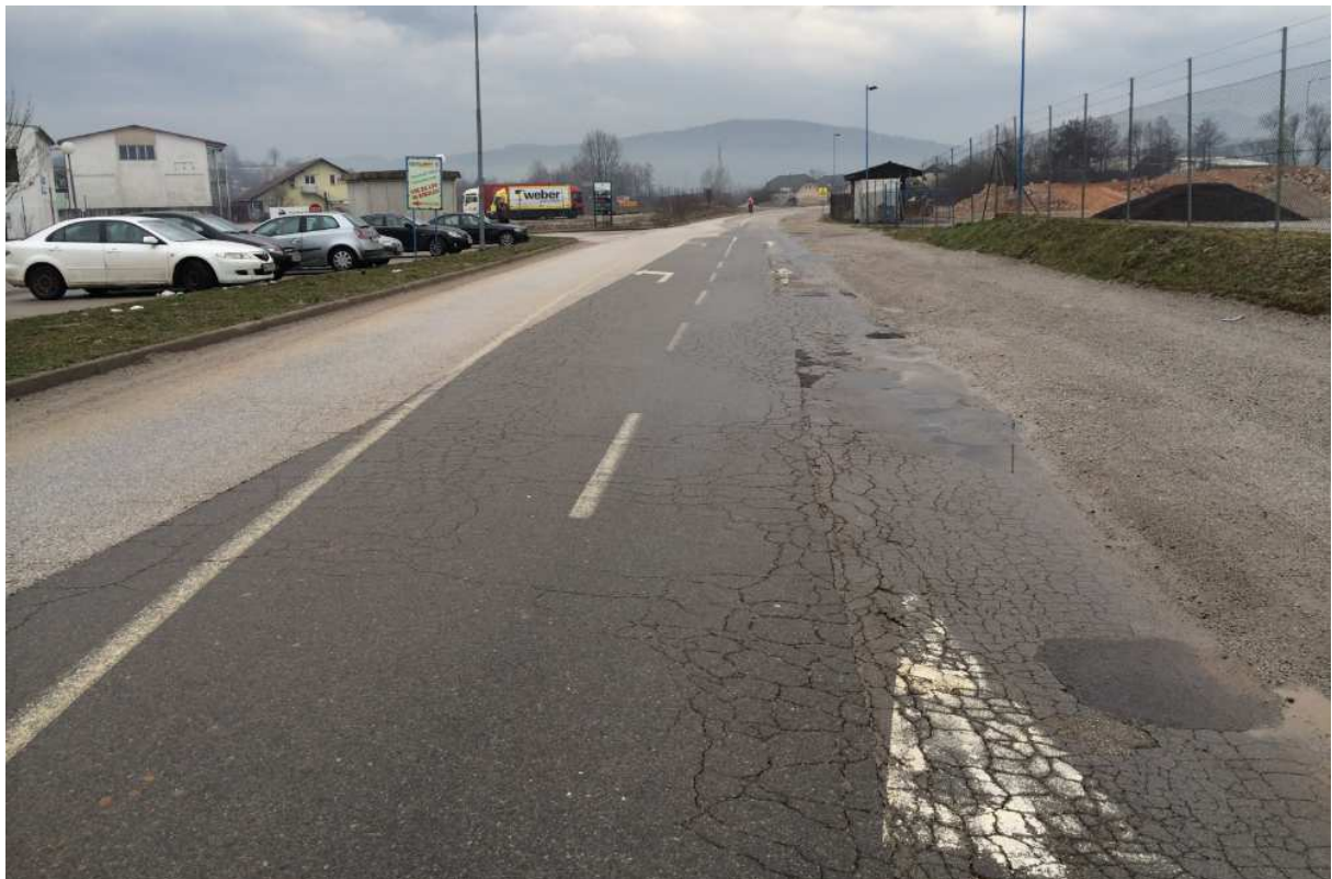
Slika 2: Križišče. Pogled iz kraka A (iz Grosuplja proti Ponovi vasi), vidne so poškodbe na vozišču in slabo vidne označbe na vozišču.
