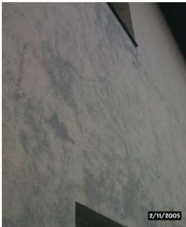
Slika 2: Razpoke na zunanjem zidu (Kušar 2005)
