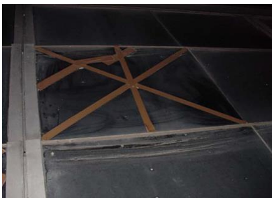
Slika 23: Porušitev zaradi temperaturnih sprememb [11]
