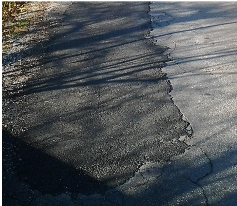
Slika 7: Primer neustrezno popravljene poškodbe
