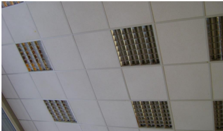
Slika 10: Spuščen ("armstrong") strop v igralnicah št. 12, 16 in 17, ki ugodno vpliva na skrajšanje odmevnega časa v prostoru.
