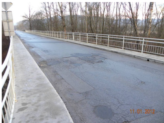
Slika 9: Poškodbe vozišča; mrežaste razpoke in udarne jame (ZRMK, 2012)
