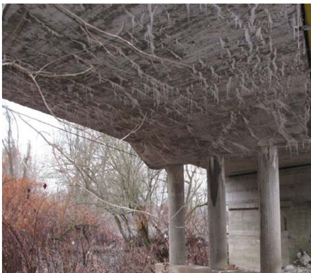
Slika 6: Poškodbe prekladne konstrukcije (ZRMK, 2012)
