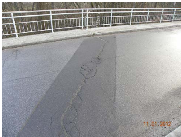
Slika 11: Poškodba vozišča; območje dilatacije (ZRMK, 2012)
