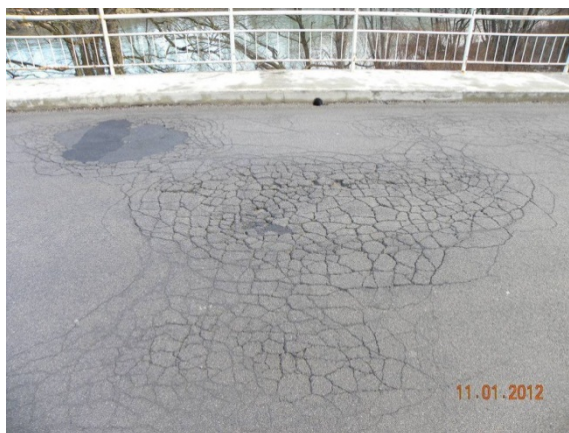
Slika 10: Poškodbe vozišča; mrežaste razpoke (ZRMK, 2012)
