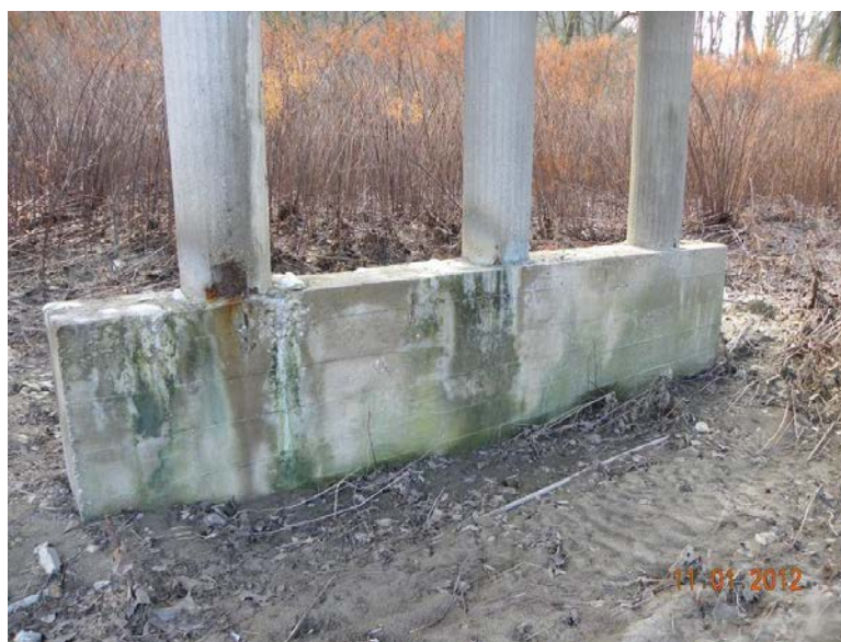
Slika 2: Poškodbe betona temeljne grede vmesnega opornika (ZRMK, 2012)
