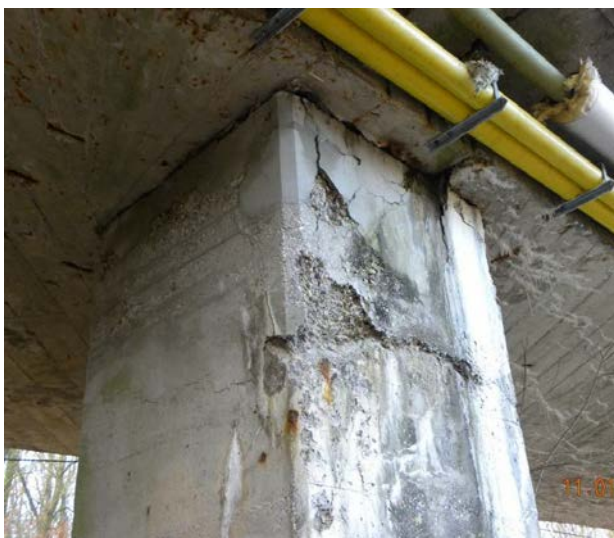
Slika 3: Poškodbe betona krajnega opornika (ZRMK, 2012)
