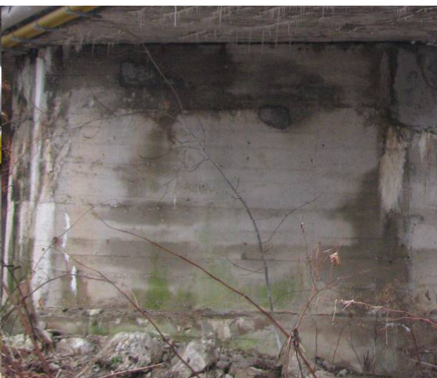
Slika 4: Poškodbe betona krajnega opornika (ZRMK, 2012)
