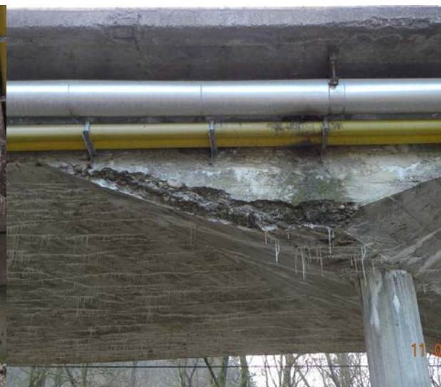
Slika 7: Poškodba prekladne konstrukcije v območju vut (ZRMK, 2012)
