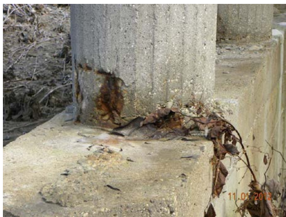
Slika 5: Poškodbe vmesnega opornika (ZRMK, 2012)
