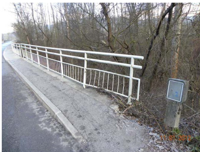
Slika 12: Mehanske poškodbe ograje (ZRMK, 2012)
