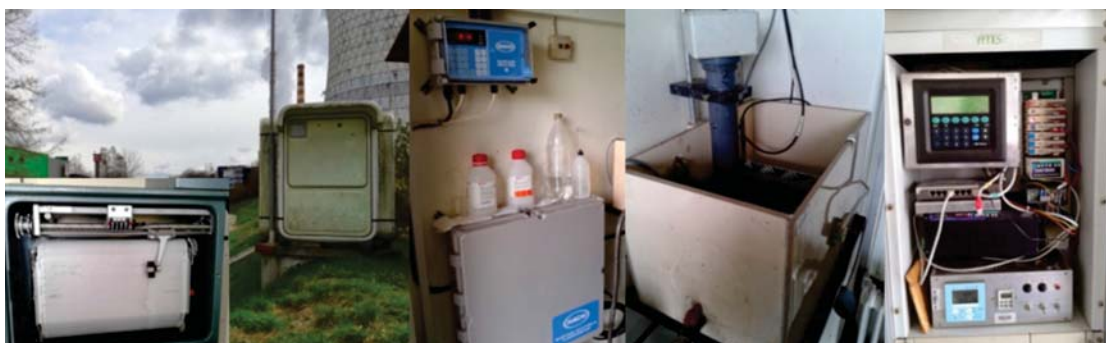
Slika 21: Merilna postaja in njena oprema, [19]
