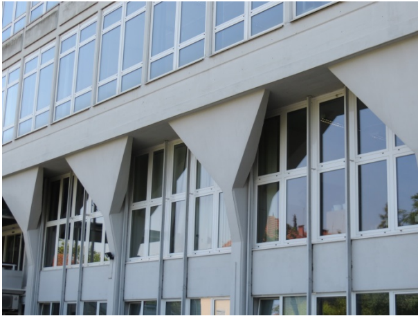
Slika 27: Horizontalni linijski toplotni most nad pritličjem in vertikalni linijski toplotni most med okni in stebri
