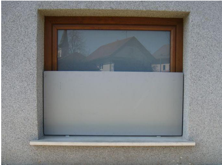
Slika 21: Prikaz zaščite odprtih v objektu (PAL inženiring – Panelna zaščita WHS, 2014)
