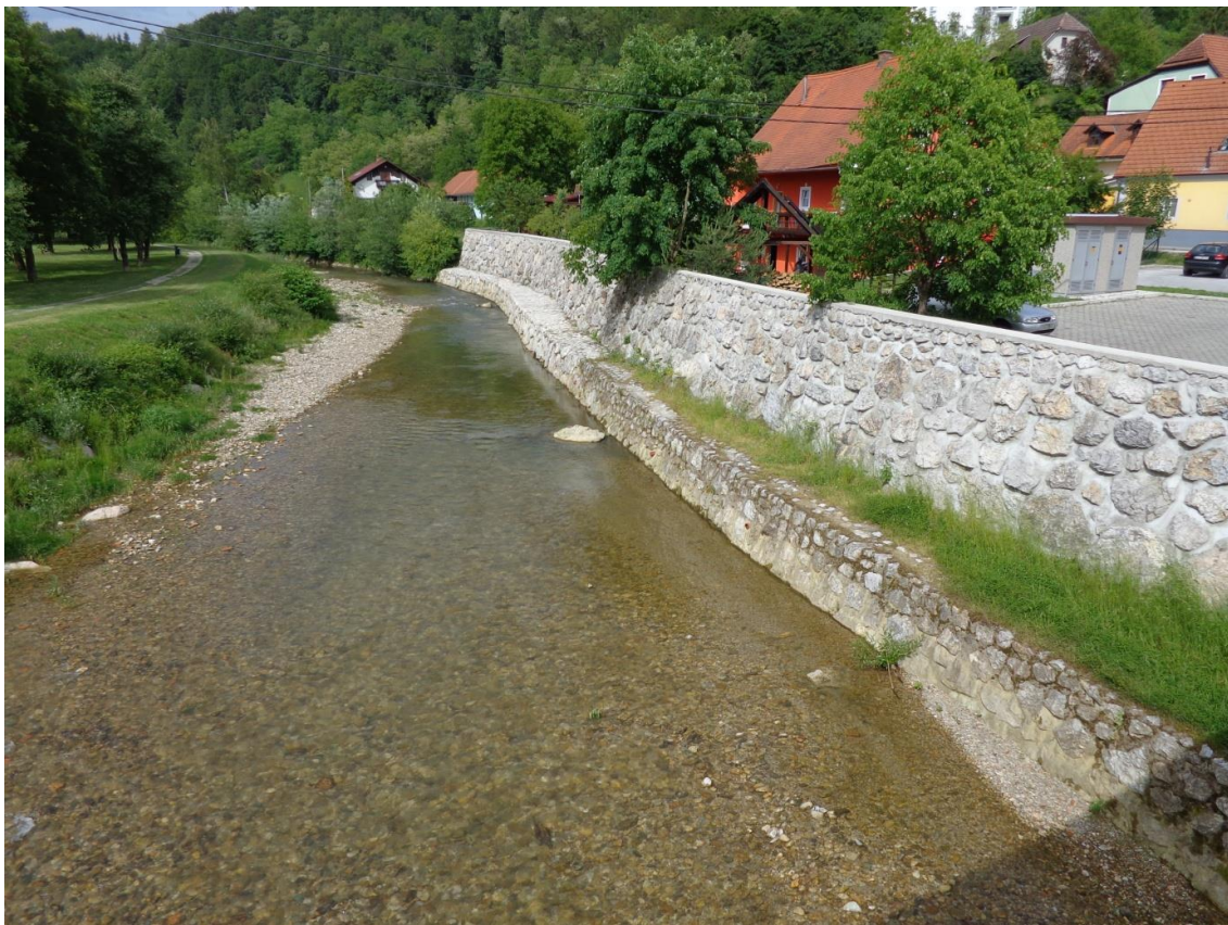
Slika 17: Protipoplavni zidovi v Vojniku
