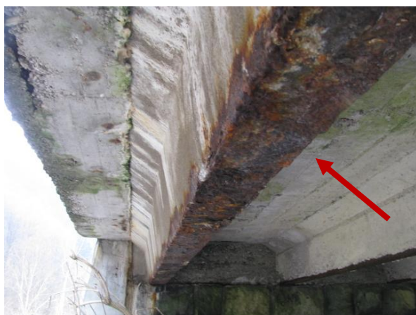
Slika 5.9: Korozija spodnje pasnice na jeklenem mostu GO 0120
