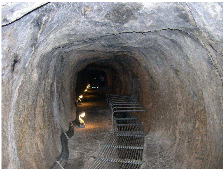
Slika 1: Grški vodni predor na otoku Samos, ki je bil zgrajen leta 530 pr. n. št. (vir: Tunnel of Eupalinos. 2014. Wikipedia)
