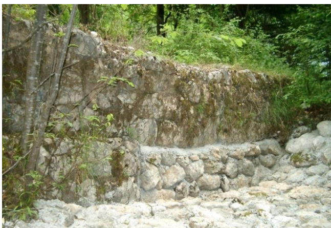
Slika 17: Porasel gabion (Avtor: Zakotnik)
