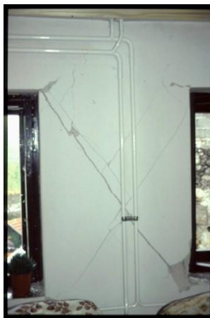
Slika 6: Strižna porušitev zidovja (Fischinger, 1998).
