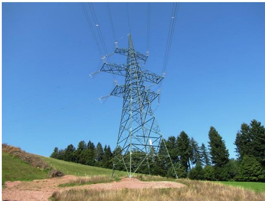
Slika 8: Primer 400 kV daljnovoda oblike "sod"
