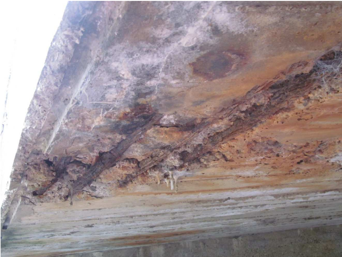
Slika 5: Korodirana armatura in odpadli zaščitni sloj betona
