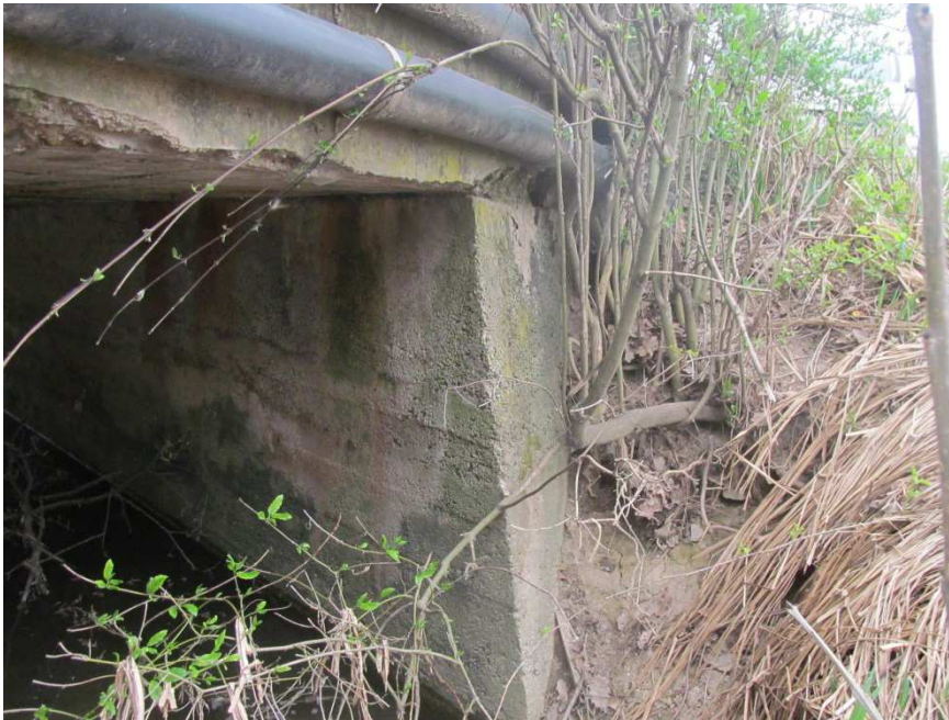
Slika 4: Prekomerno poraščen teren in odpadanje krovnega sloja betona
