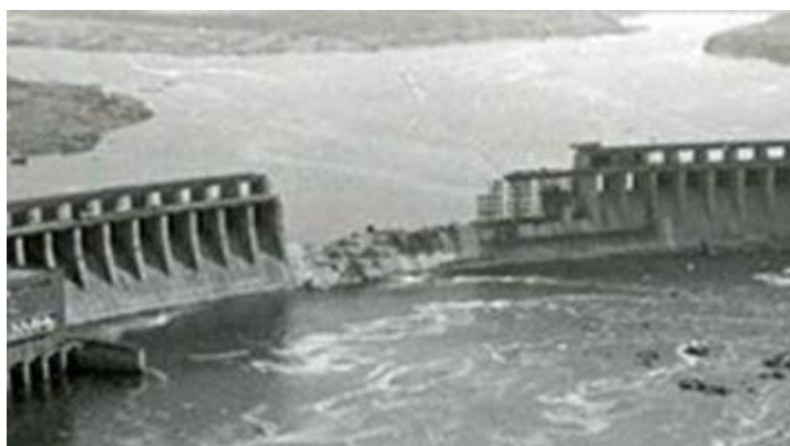
Slika 9: Poškodbe na pregradi Dneprostroj, Ukrajina (Vir: http://i.ytimg.com/vi/a-9h9DRrQvg/hqdefault.jpg )
