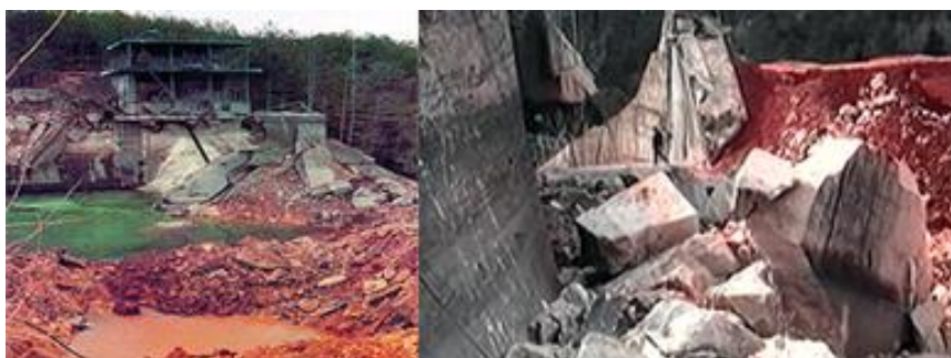
Slika 4: Poškodovani del pregrade in detajl poškodbe (Vir: dokumentarni film - Miniranje pregrade Peruća, [9])
