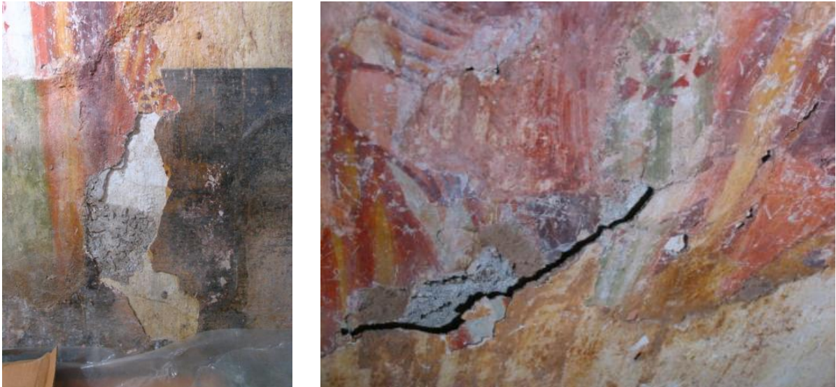
Slika 2: Poškodbe na stenskih slikah v cerkvi sv. Nikolaja na Godešiču (avtor slike: Anita Kavčič Klančar)
