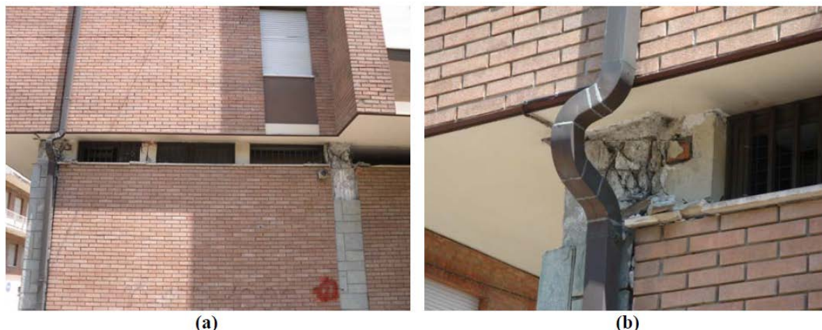
Slika 2.4: (a) AB okvir s polnilom; (b) poškodbe kratkih stebrov zaradi interakcije s polnilom; (Parisi in sod., 2012)
