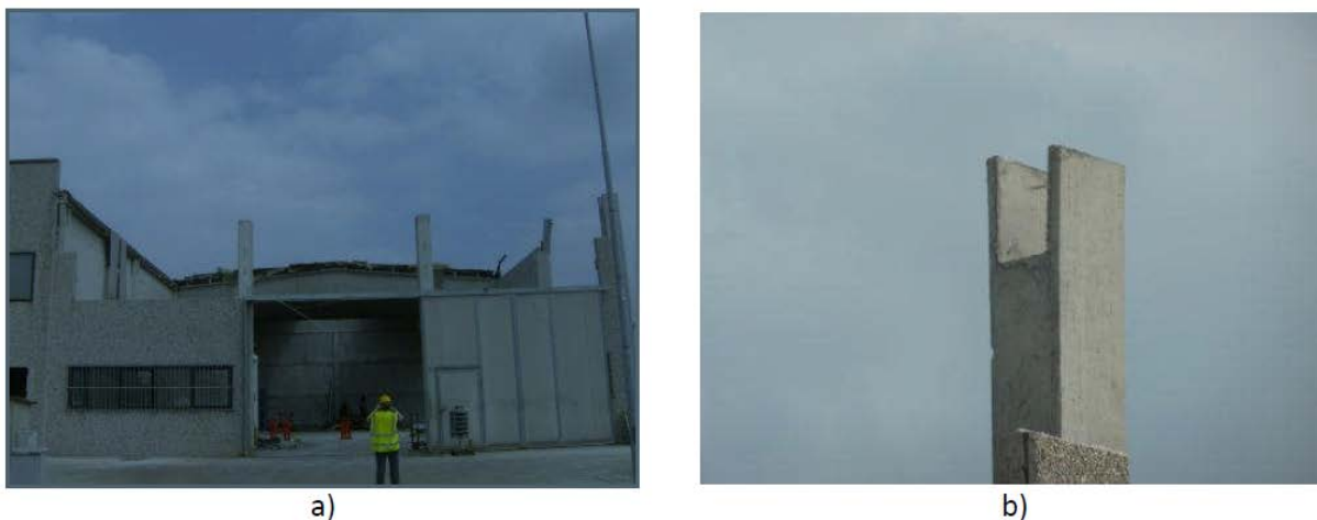
Slika 2.2: Porušitev objekta v kraju Cosumaro; (a) porušitev strešnega T-nosilca; (b) detajl izvedenega stika; (Ioannou in sod., 2012)
