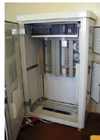
Slika 42: Semaforska krmilna naprava
