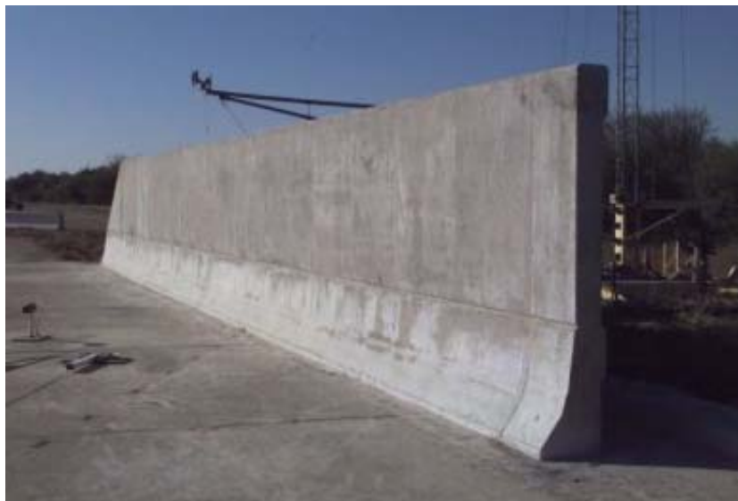
Slika 45: Betonska varnostna ograja F oblike
