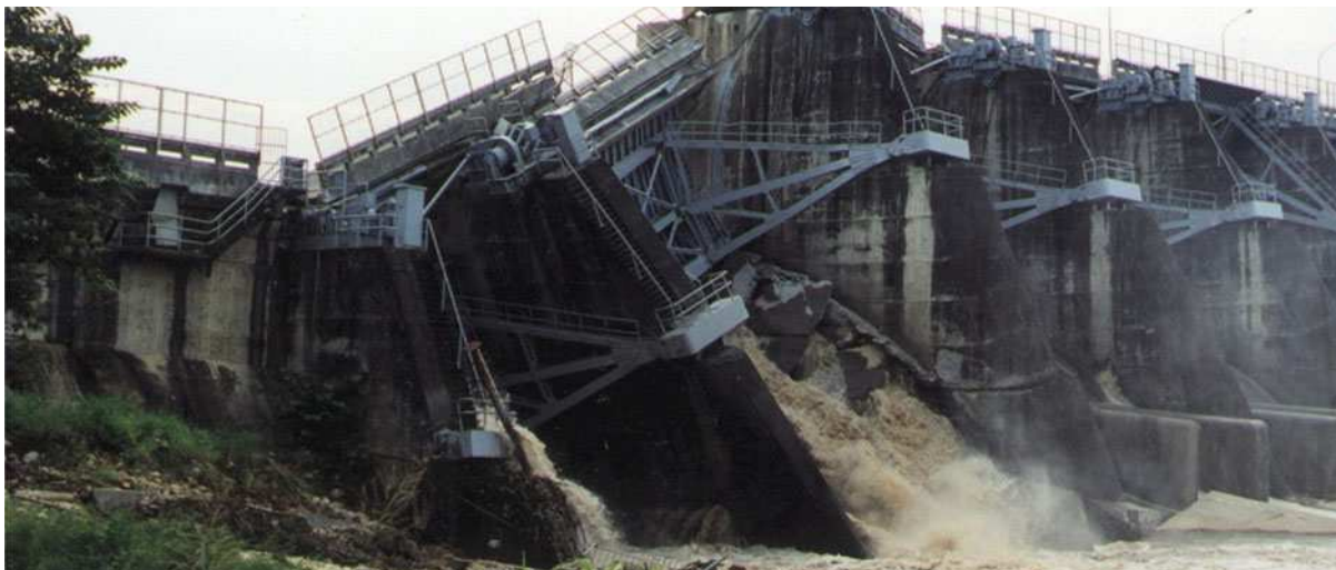
Slika 2: Poškodbe na pregradi Šiš Kang po potresu v Tajvanu leta 1999
