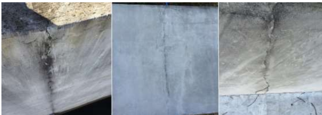
Slika 19: Razpoke na sanirani površini na mestih, kjer bi morale biti dilatacije
