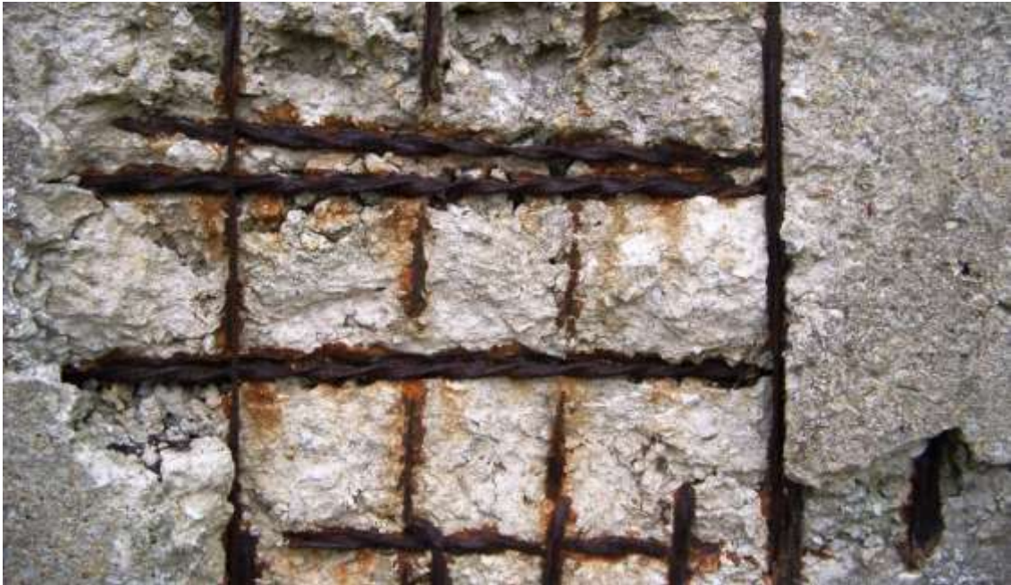
Slika 2: Poškodovana površina AB konstrukcije z vidno korodirano armaturo
