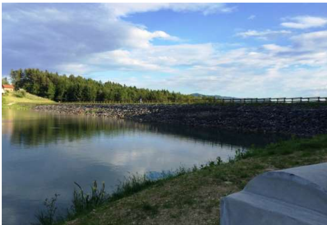
Slika 4: Zemeljska pregrada Loče
