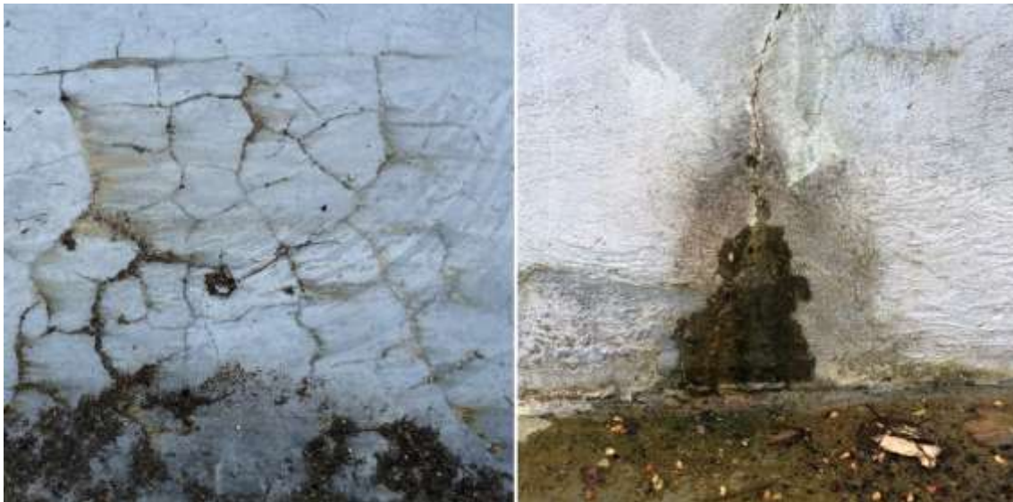
Slika 18: Zaledna voda prihaja na površje skozi razpoke na betonski površini
