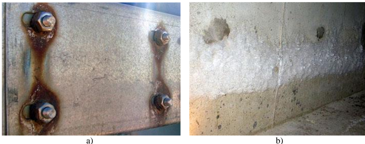
Slika 27: a) galvanjska korozija ob stiku konstrukcijskega in nerjavečega jekla, b) pojav cvetenja na betonski steni
