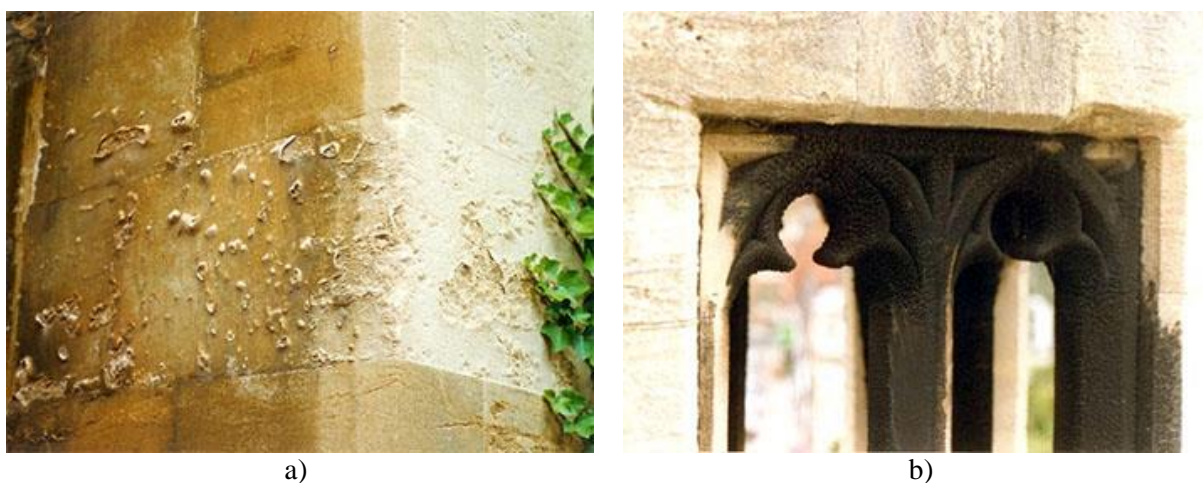
Slika 35: a) sulfatna korozija apnenca, b) črna skorja na delu, ki je zaščiten pred dežjem
