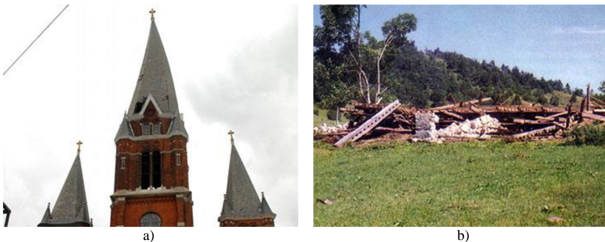
Slika 41: a) deformacije konice zvonika na cerkvi v Detroitu zaradi viharja, b) porušen objekt zaradi tornada na Notranjskem, 1986
