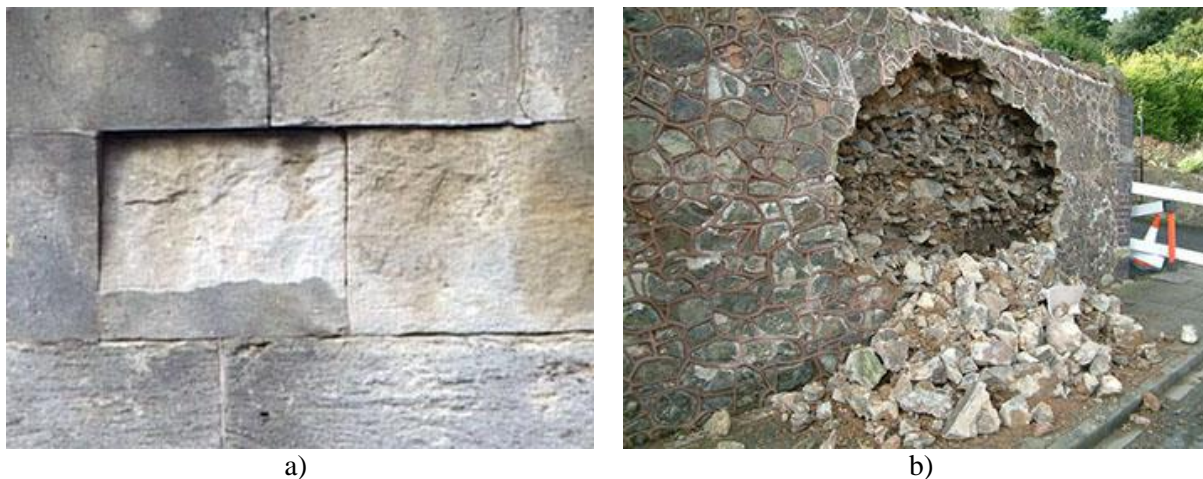
Slika 20: a) odpadanje kamna – posledica zmrzali, b) izguba adhezije zaradi odpovedi malte in ločevanje zidu, verjetno posledica zmrzali
