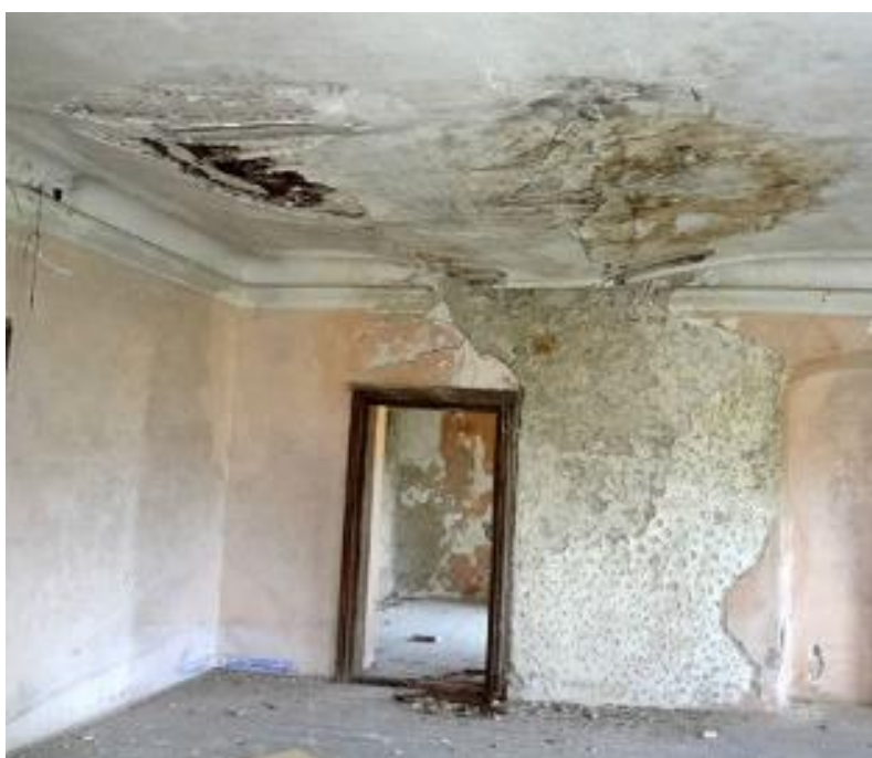
Slika 10: Hude poškodbe materialov in porušitev medetažne konstrukcije – grad Lože
