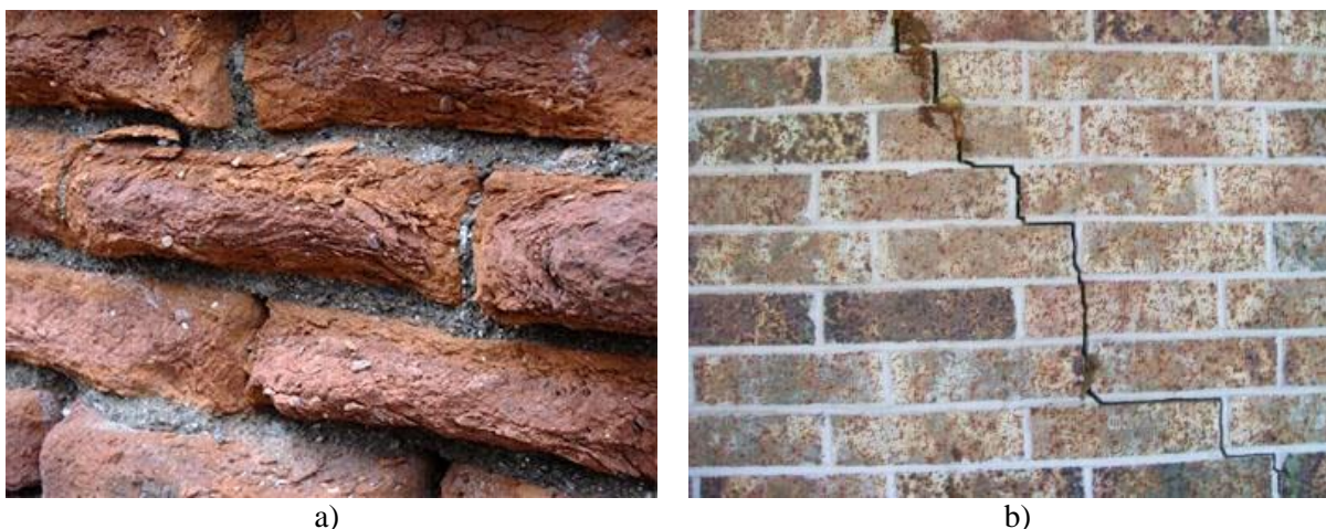
Slika 18: a) prepevanje opeke, b) stopničasta razpoka v zidu je posledica temperaturnih raztezkov
