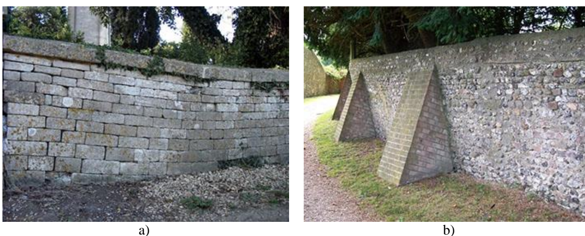
Slika 37: a) neenakomerno posedanje zidu brez temeljev, b) podpiranje nagnjenega zidu
