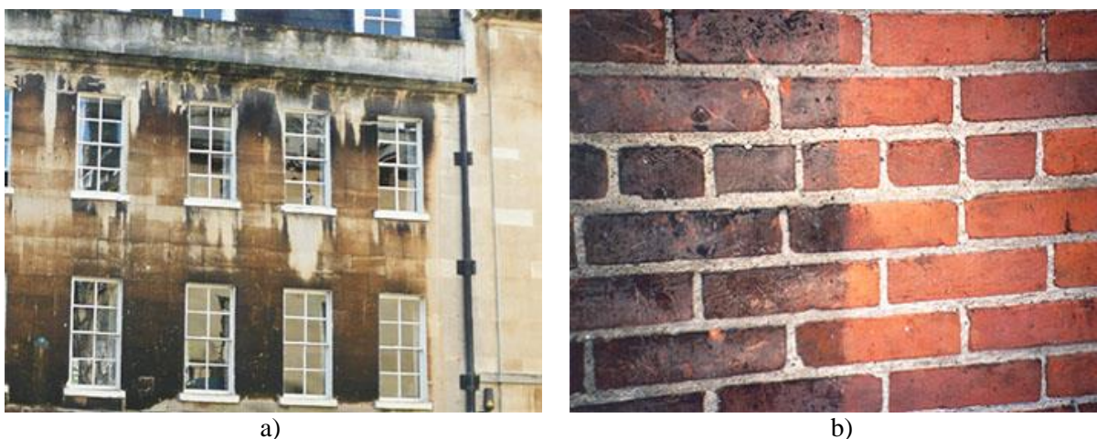
Slika 33: a) umazanija na fasadi zaradi nabiranja saj v porah, na desni očiščena, b) umazan in očiščen opečni zid
