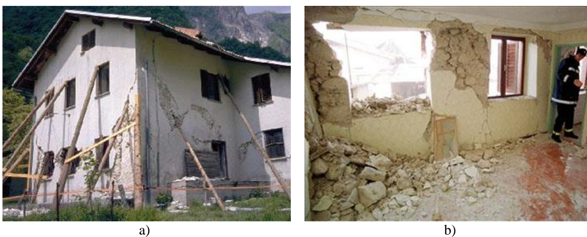
Slika 54: a) začasno podprt objekt iz neobdelanega kamna z globokimi razpokami v nosilnih stenah in delno porušitvijo vogalov, b) notranjost poškodovane stavbe
