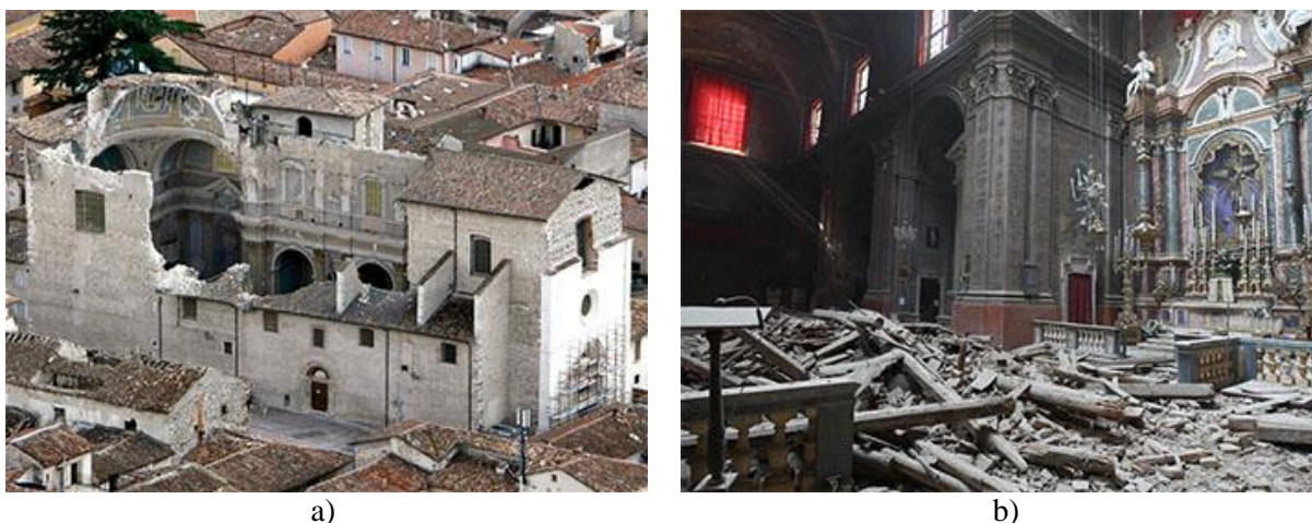
Slika 53: a) porušena cerkev Santa Maria Paganica v L'Aquili, 2009, b) notranjost cerkve, poškodovane v potresu
