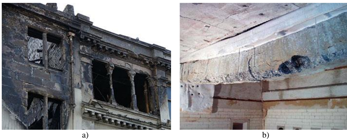
Slika 46: a) posledice požara na stavbi iz apnenca v Glasgowu, b) v laboratorijskem požaru porušen testni armiranobetonski nosilec
