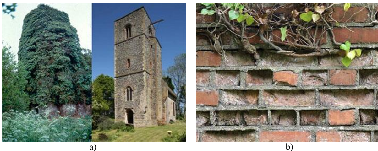
Slika 14: a) z bršljanom obraščena cerkev, desno po odstranitvi vegetacije in obnovi, b) delovanje korenin in zmrzali na opečnem zidu v močni malti
