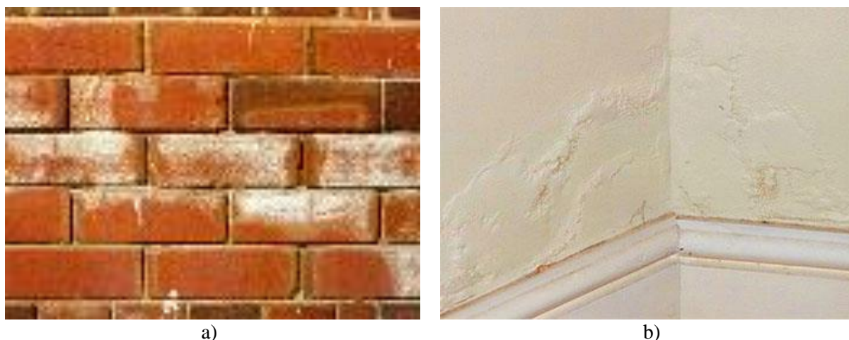
Slika 28: a) sledi cvetenja na opeki kot posledica dviga vlage, b) prikrito cvetenje zaradi kapilarnega dviga povzroča odpadanje površinskega sloja
