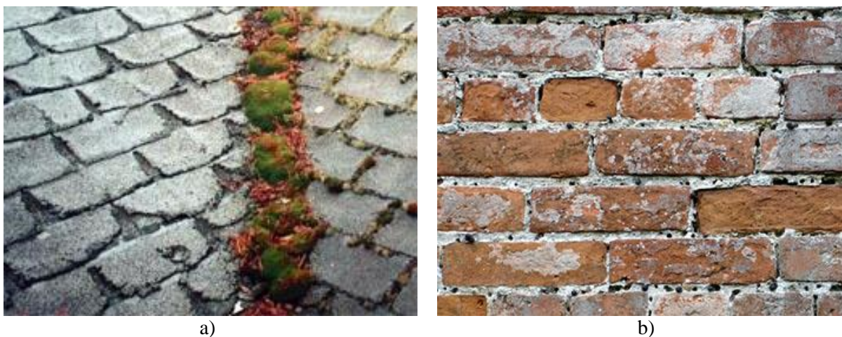
Slika 15: a) mah na strehi, b) votlikavost opečnega zidu zaradi žuželk
