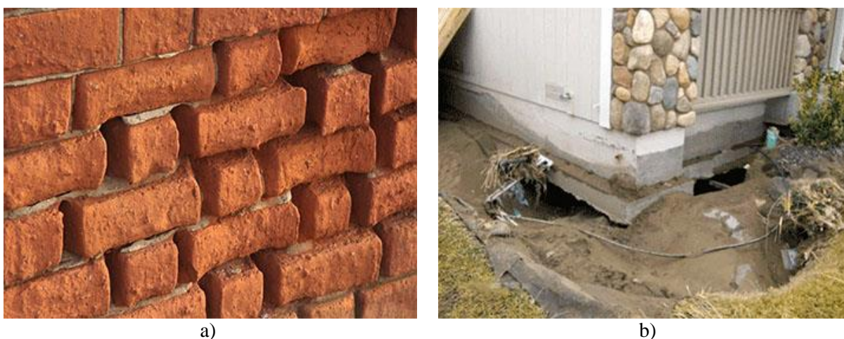
Slika 23: a) erozija zaključnih fug v spojnica, b) erozija tal ogroža stabilnost stavbe
