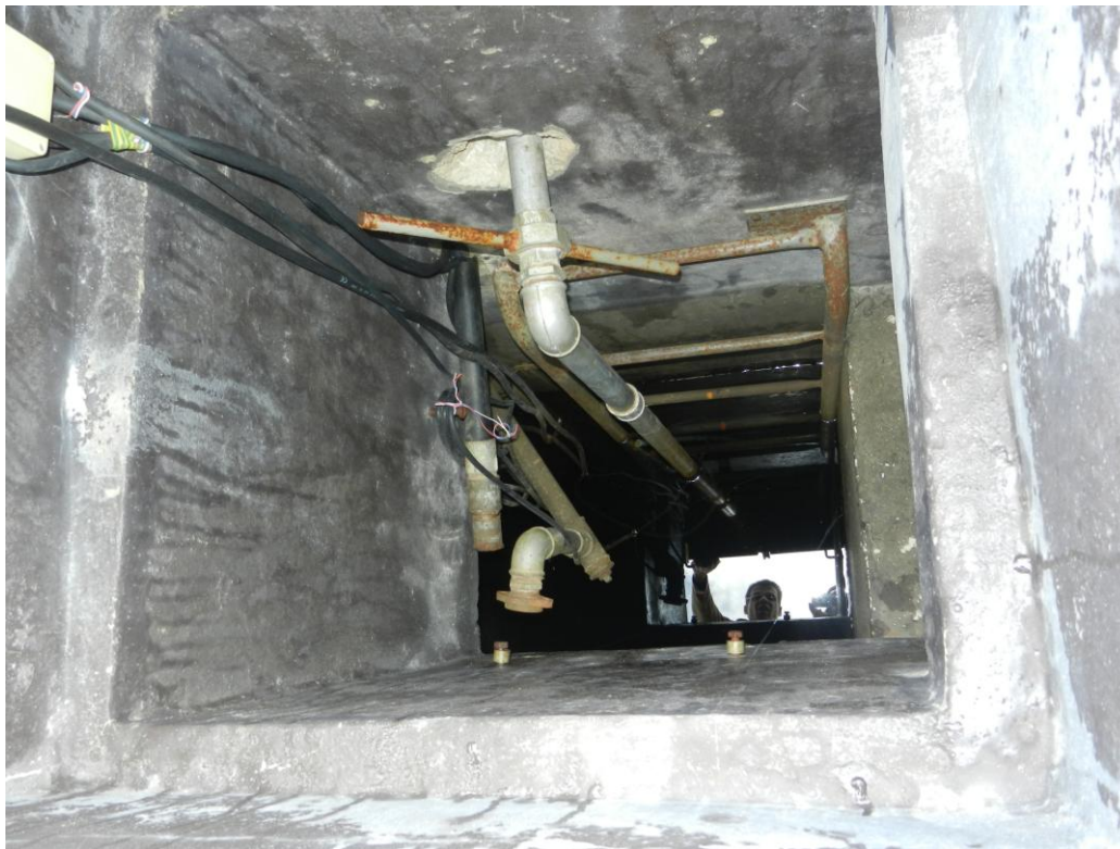
Slika 50: Pogled v večji rezervoar
