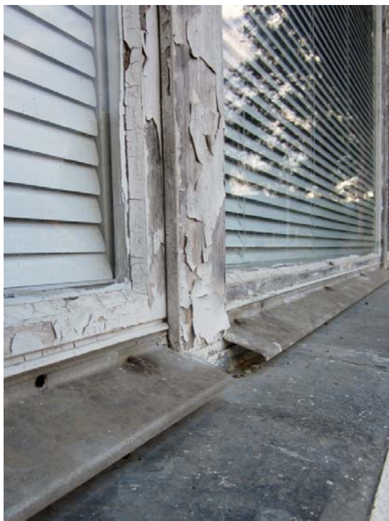
Slika 5: Dotrajanost oken na objektu (vir: lasten)
