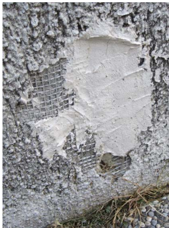
Slika 6: Poškodovana fasada (vir: lasten)
