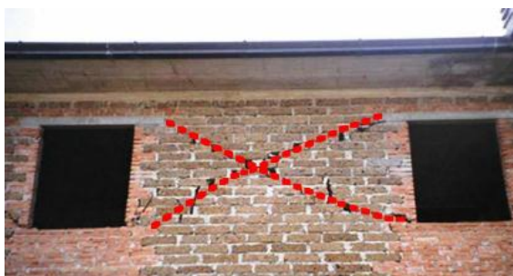
Slika 2-19: Mehанизem strižne porušitve v delu med okenskimi odprtinami (S.T.A. Data, General description, v.4)
