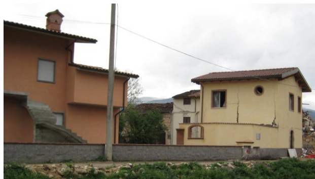
Slika 2-11: Primerjava dveh objektov, zgrajenih v različnih obdobjih. Novejši objekt (levo) je po potresu ostal nepoškodovan, medtem ko so na nekoliko starejšem objektu (desno) vidne posledice (razpoke) - L`Aquila (It.), 2009
