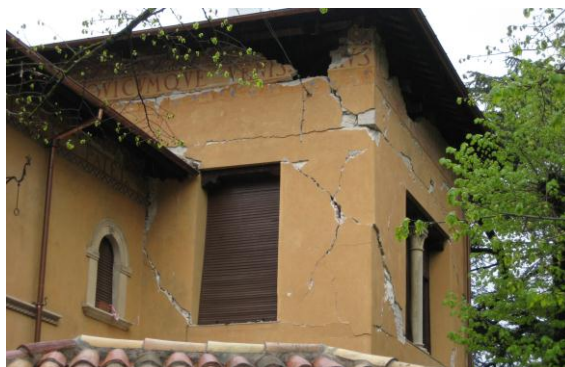
Slika 2-9: Prikaz strižnih poškodb po potresu - L`Aquila (It.), 2009
