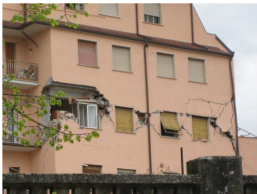
Slika 2-10: Delna porušitev in razslojevanje zidu ter diagonalne razpoke - L`Aquila (It.), 2009
