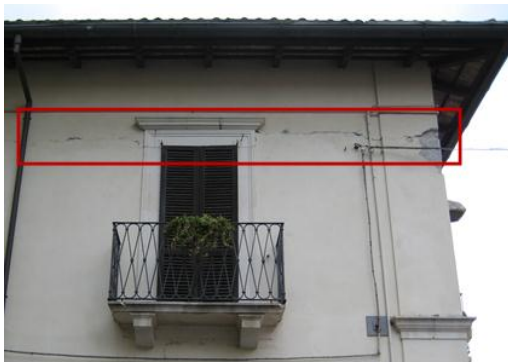
Slika 2-8: Nastanek vodoravnih razpok v horizontalnih spojnica zidu - L`Aquila (It.), 2009
