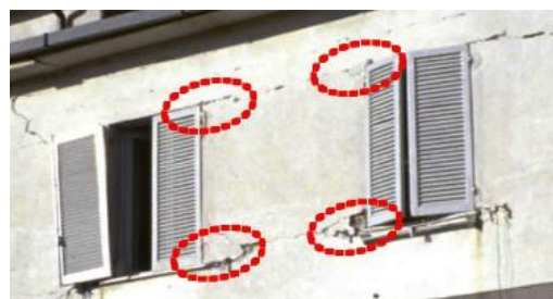
Slika 2-20: Upogibna porušitev zidu zaradi prekoračene tlačne trdnosti zidovja (S.T.A. Data, General description, v.4)
