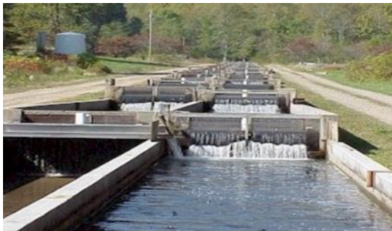
Slika 9: Pretočna ribogojnica z vzrejnimi bazeni v kaskadah
