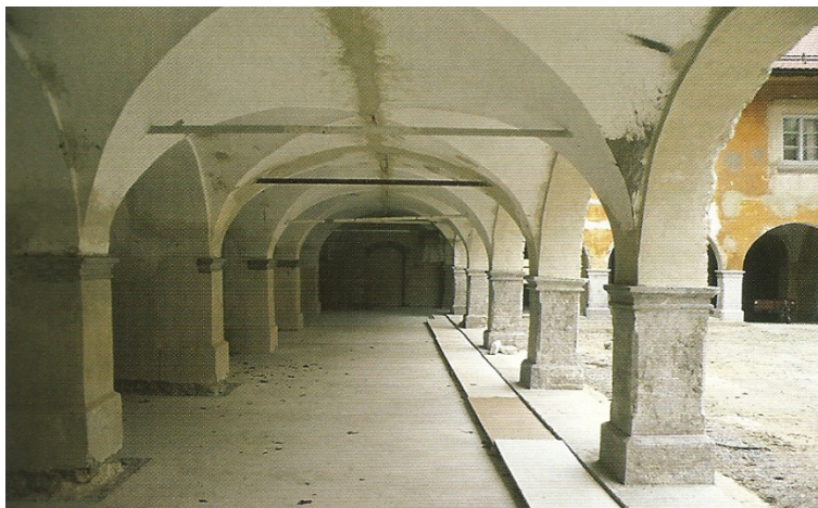
Slika 2.9: Del severnega arkadnega hodnika v pritličju, ki je bil prenovljen za potrebe restavratorskih delavnic. Pri obnovi so bile nameščene železne vezi. (vir Stopar, 2000)
