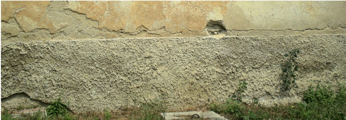
Slika 2.14: Vodoravna razpoka na fasadi zahodnega trakta.
