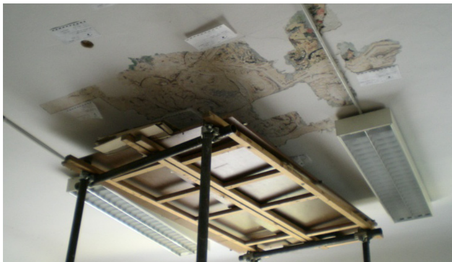
Slika 2.11: Nevarno povešen lesen strop zaradi lesne gobe.
