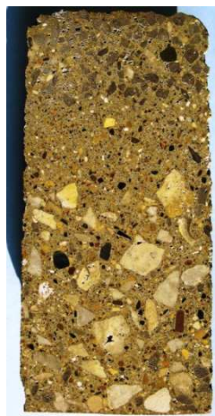
Slika 5: Segregacija betona v strjenem stanju
